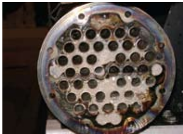
Rys. 16. Stan rurek skraplacza agregatu po trzech latach eksploatacji
