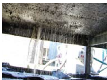
Rys. 15. Spływający od góry roztwór usuwa kamień wodny, a rozluźnione zanieczyszczenia organiczne wypłukuje z lameli na tacę
