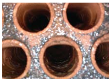
Rys. 2. Stan po czyszczeniu wyciorem
