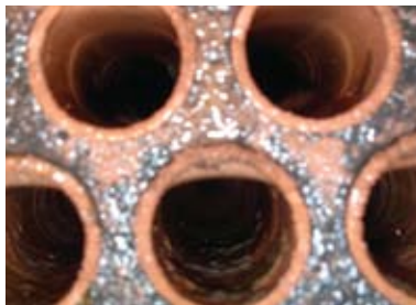
Rys. 18. Stan rurek skraplacza po dwóch latach eksploatacji
