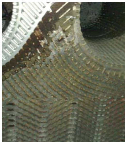
Rys. 3. Zdemontowane, bardzo zakamienione płyty wymiennikowe
