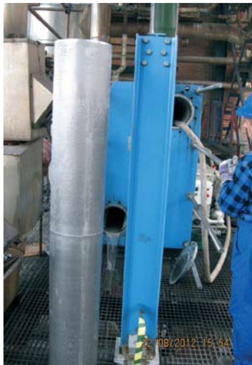
Rys. 18. Widok odkamienionego filtra
